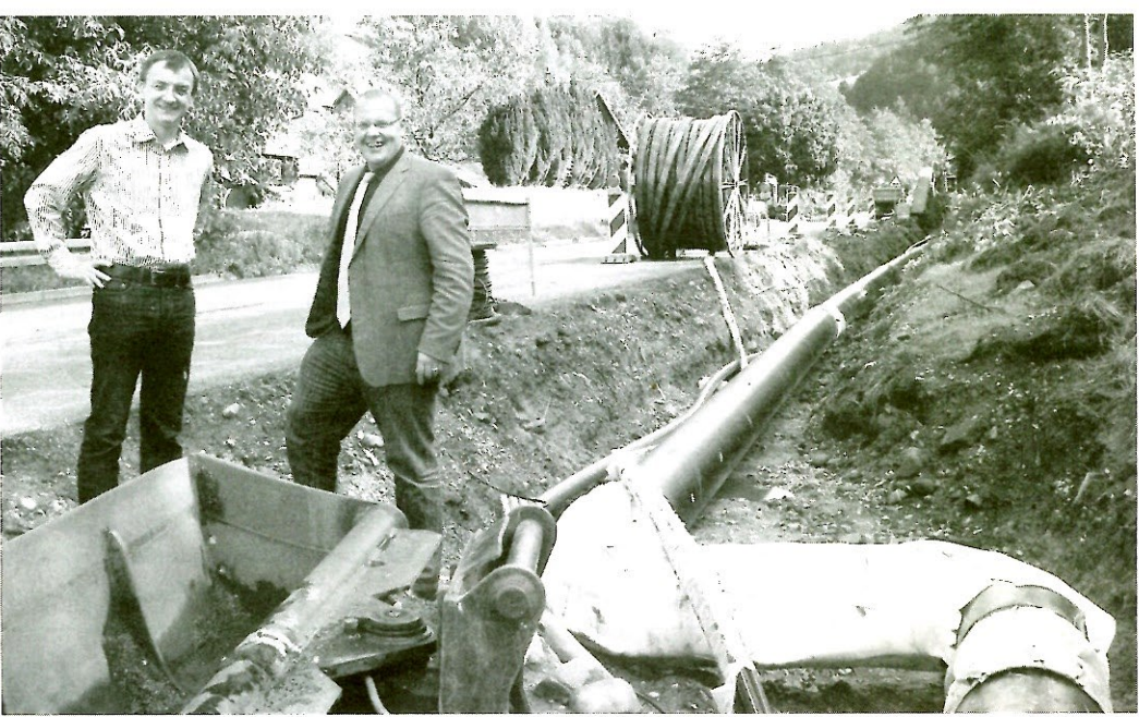
Unternehmer Manuel Echte (links) und Bürgermeister Carsten Erhardt sind zufrieden mit dem Fernwärmeprojekt. Am 1. April dieses Jahres wurde mit dem Leitungsbau begonnen, jetzt sind schon drei Kilometer fertig. Der Kanalbau im Bereich der Talstraße ist kurz vor dem Anwesen Finkenzyeller.
