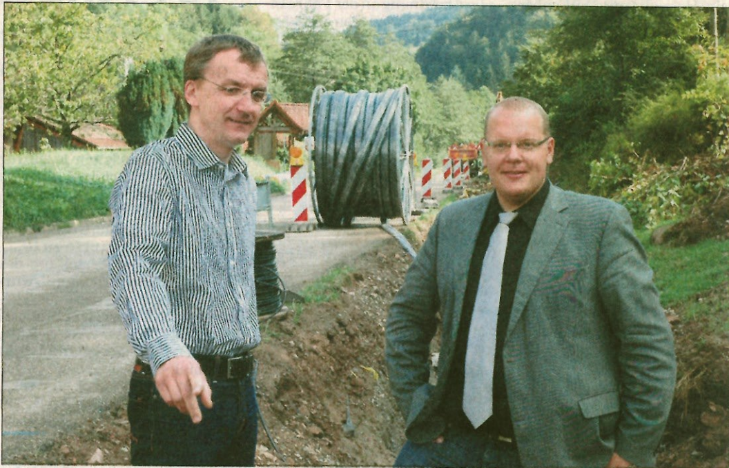
Manuel Echtle (links) und Bürgermeister Carsten Erhardt inspizieren die Baustelle der Fernwärmeleitung. Die Arbeiten sind weit fortgeschritten, haben inzwischen den Ortsausgang Richtung »Kolonie« erreicht.
